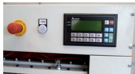
Particolare quadro comandi PLC
